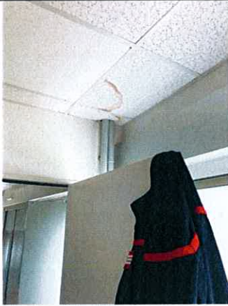
Condensats au niveau des piquages en faux-plafond
