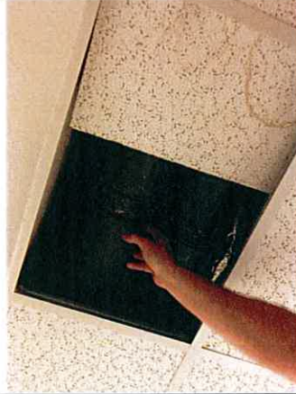
Mauvaise isolation au niveau des colliers de suspension. Condensats visibles sur dalle
